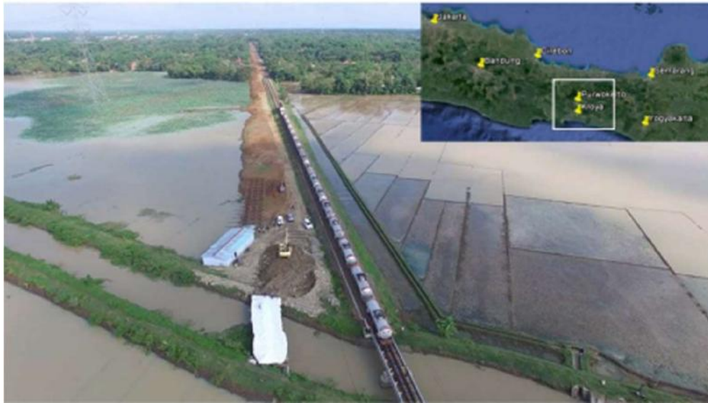
Gambar 1-1 Lokasi Pekerjaan Pembuatan Timbunan Badan Jalan Rel Jalur KA Antara Purwokerto Dan Kroya (Promisco, 2016)
