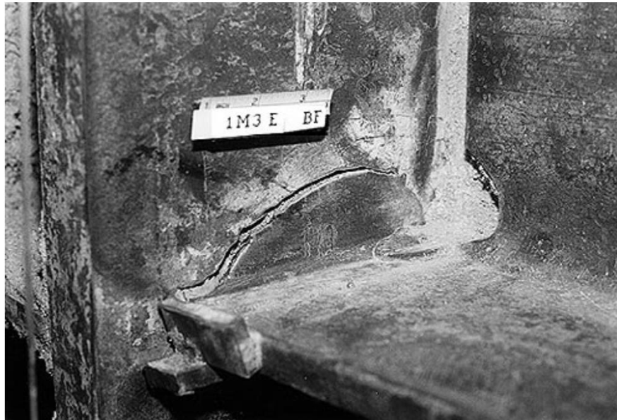
Gambar 1. 25. Kegagalan pada Sambungan Las Berkembang Menjadi Retak pada Sayap Kolom (Kegagalan Divot)
