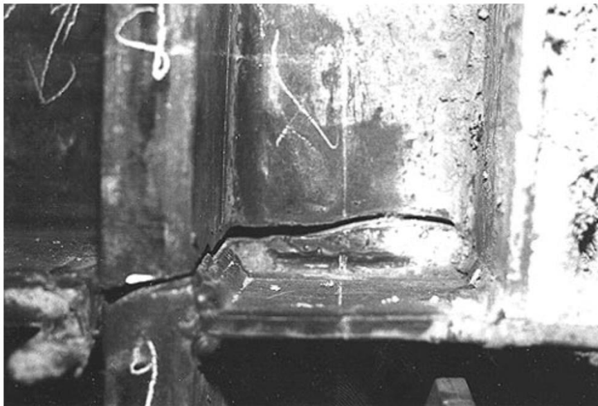
Gambar 1. 27. Kegagalan Retak dari Sayap Kolom yang Merambat ke Zona Panel
