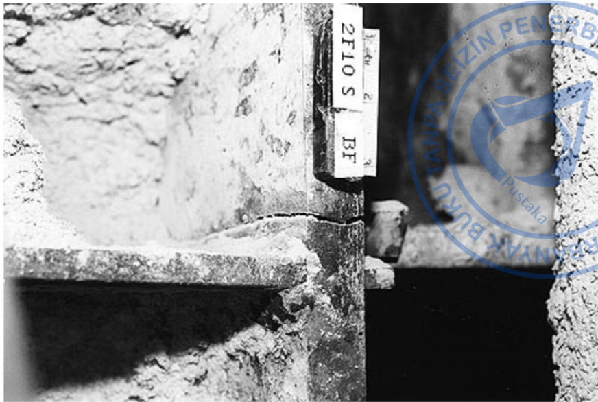
Gambar 1. 26. Kegagalan Retak yang Terjadi pada Sayap Kolom yang Seajar dengan Sayap Balok
