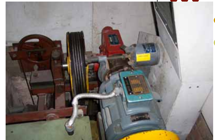
Motor Listrik (Bagian dari Plant yang dikendalikan)
