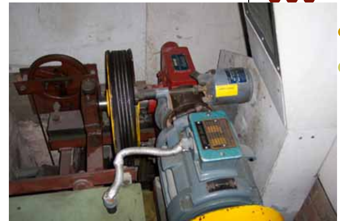
Motor Listrik (Bagian dari Plant yang dikendalikan)
