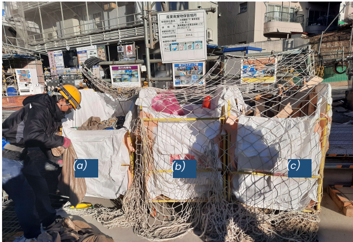
Dikelola Kontraktor : (a). Sampah Mixing Beton ; (b). Sampah Plastik ; (c). Sampah Kayu ; (d). Sampah Besi ; (e). Sampah Beton
