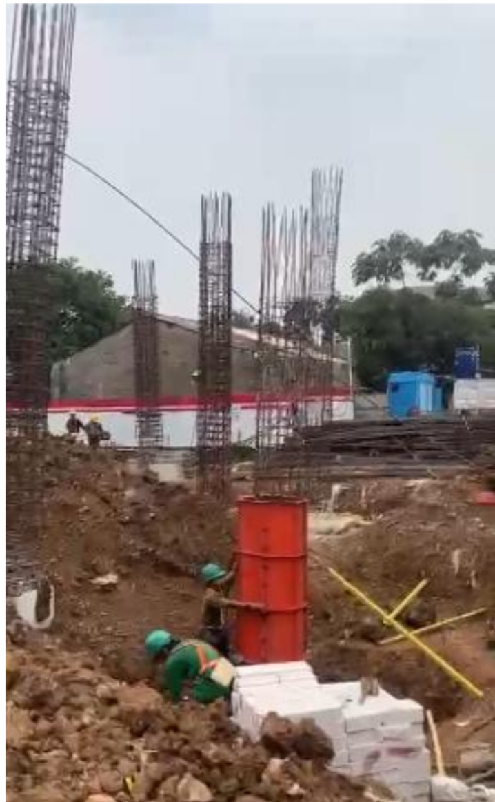
Gambar 2. Pekerja Tidak Menggunakan Sarung Tangan
