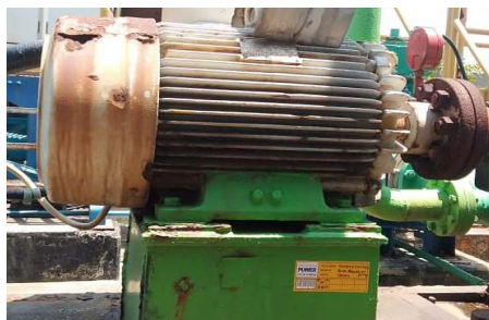
Gambar 1. Foto fisik Motor Brine Blowdown
