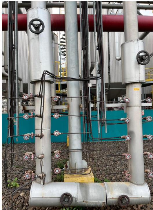
Gambar 3.3 Pipa Kapiler atau Steam Tracing
