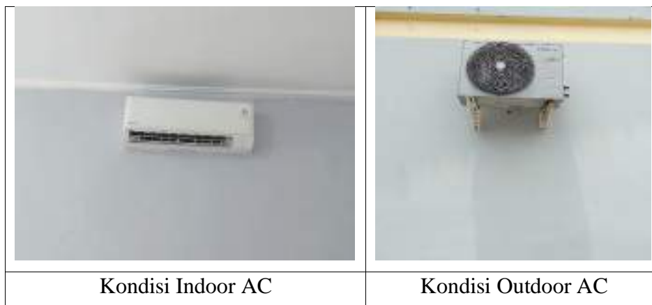
Gambar 4. 21 Sistem AC Gedung PT. Sumatera Hakarindo Sumber: Hasil Analisa di Lokasi Kegiatan
