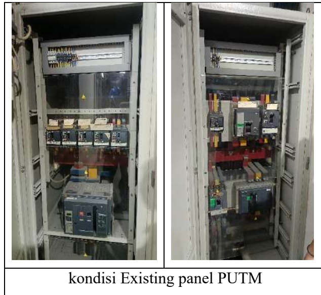
Gambar 4. 24 Kondisi panel PUTM Sumber: Hasil Analisa
