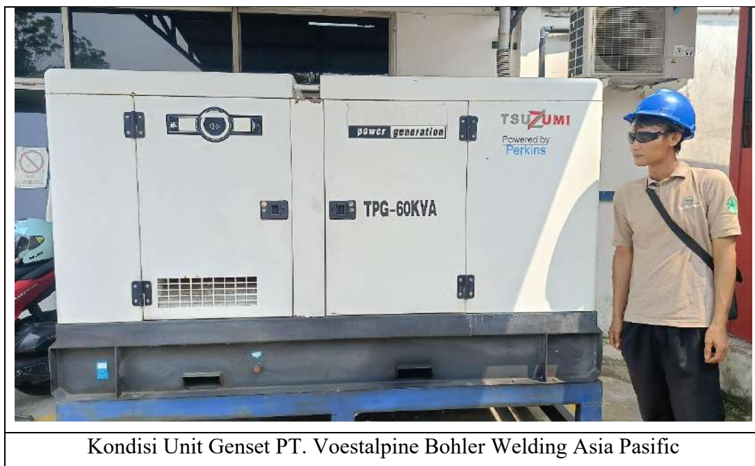
Gambar 4. 32 Kondisi Genset Sumber: Hasil Pengamatan
