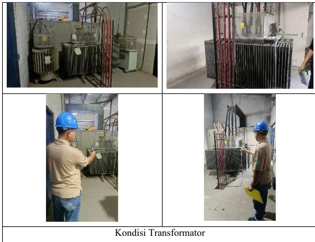
Gambar 4. 23 Kondisi Transformator Sumber: Hasil Analisa
