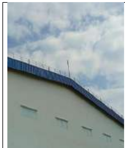
Kondisi Penangkal Petir
