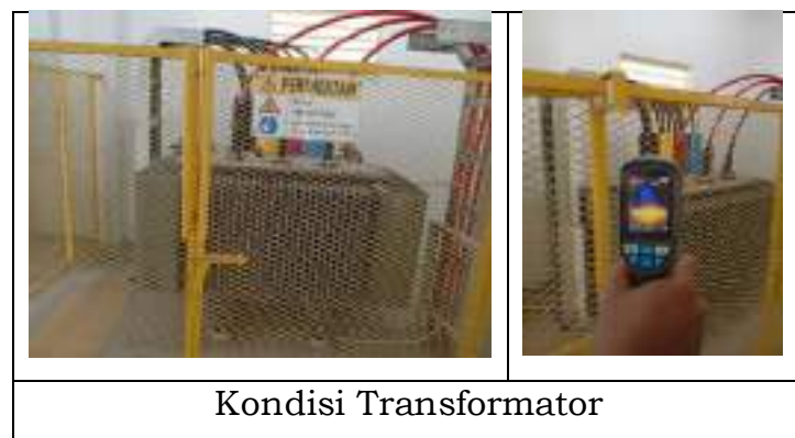
Gambar 6. 15 Kondisi Transformator Sumber: Hasil Analisa Uji Lapangan
