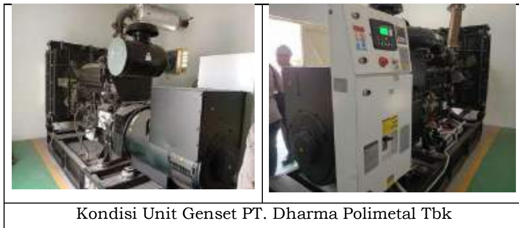
Gambar 6. 27 Kondisi Genset Sumber: Hasil Pengamatan
