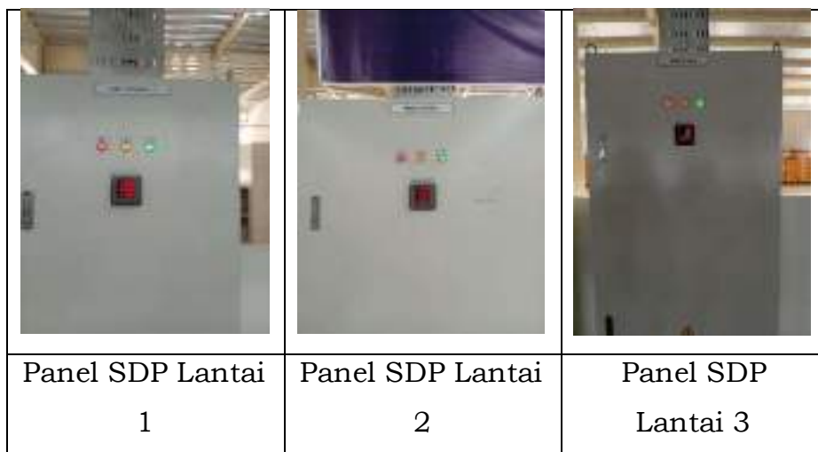
Gambar 6. 18 Kondisi Panel SDP Sumber: Hasil Analisa Uji Lapangan
