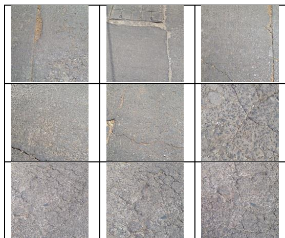
Gambar 7. Sampel jalan aspal rusak.
