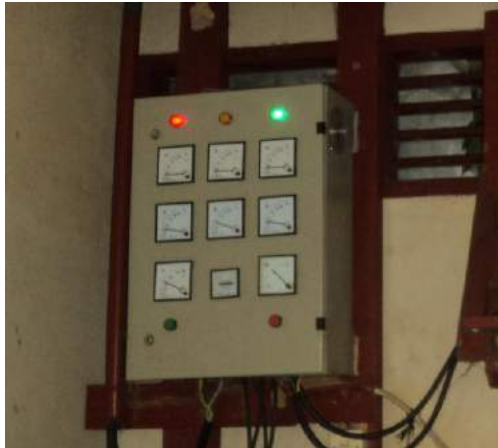
Gambar 6.15 Contoh panel MDP distribusi listrik pada PLTMH
