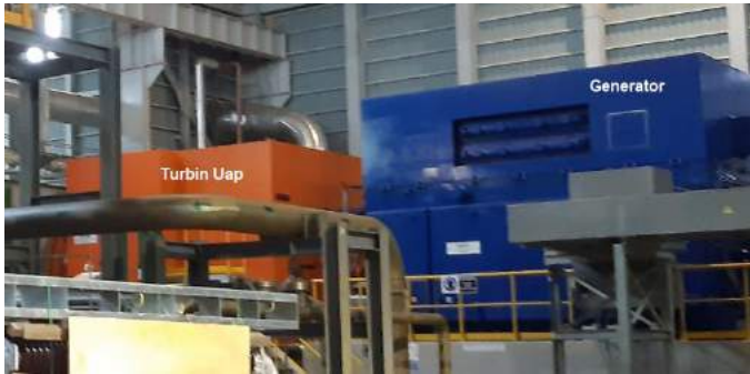
Gambar 2.7. Turbin Uap dan Generator PLTP Patuha Unit 1
