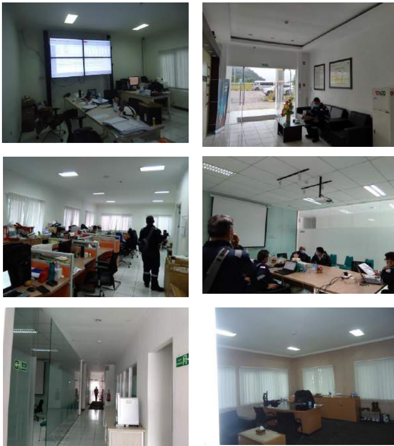
Gambar 5.14. Tata cahaya di ruangan gedung admin PLTP Patuha.
