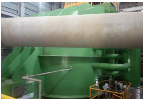
Gambar 2.8 Kondensor PLTP Patuha Unit 1
