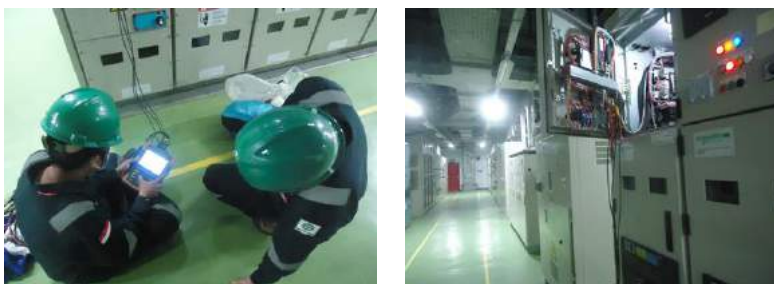
Gambar 4.7 Dokumentasi pengukuran kelistrikan di feeder 6 kV MV Board (UMVB)
