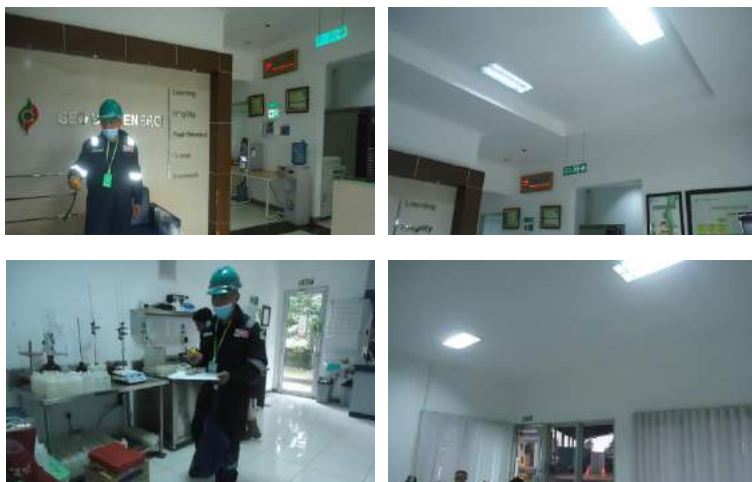
Gambar 5.25. Sistem tata cahaya di ruangan-ruangan gedung kantor basecamp PLTP Patuha.
