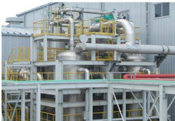
Gambar 2.11. Intercondensor PLTP Patuha Unit 1
