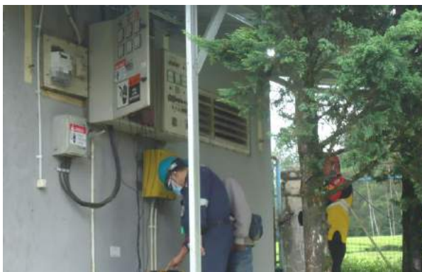
Gambar 5.20. Pengukuran kelistrikan di panel incoming gedung kantor basecamp PLTP Patuha
