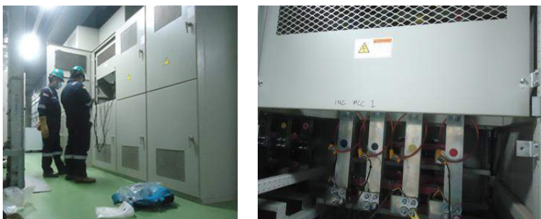
Gambar 4.9 Dokumentasi pengukuran kelistrikan di feeder 380 Volt LV Board MCC-1
