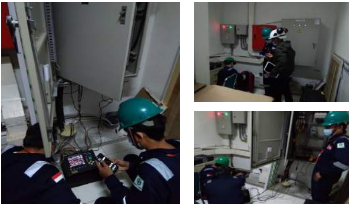
Gambar 5.4. Pengukuran kelistrikan di panel incoming gedung admin
