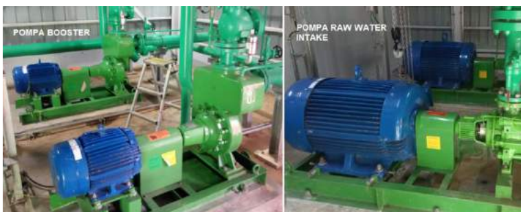
Gambar 2.17. Pompa Raw Water Intake dan Booster PLTP Patuha Unit-1
