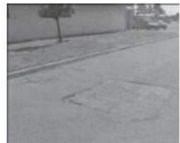
C. Tambalan keparahan tinggi
