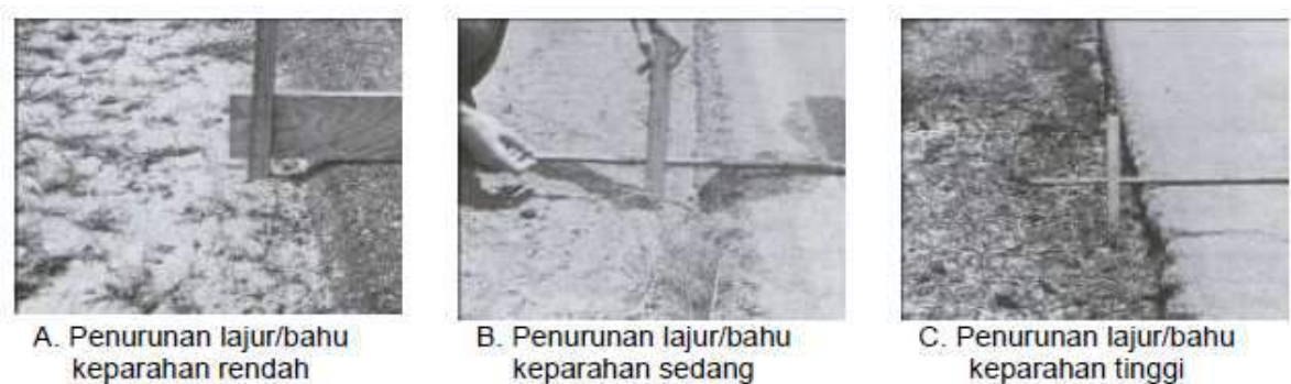
Gambar 2.18 Tingkat Keparahan Penurunan Lajur/Bahu
