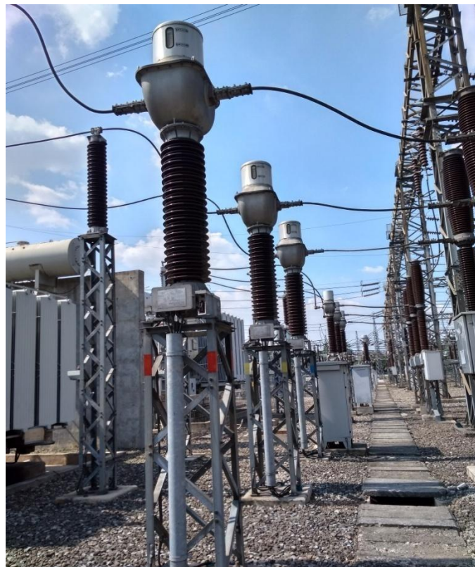
Gambar 2. Transformator Tegangan pada GI Depok
