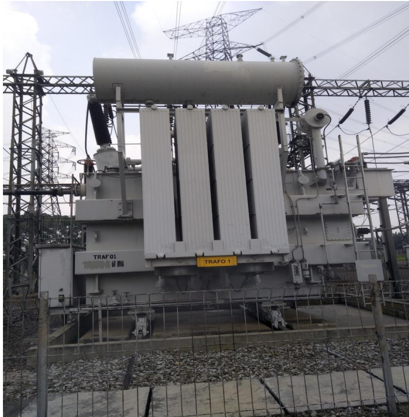
Gambar 5. Transformator pada GI Depok
