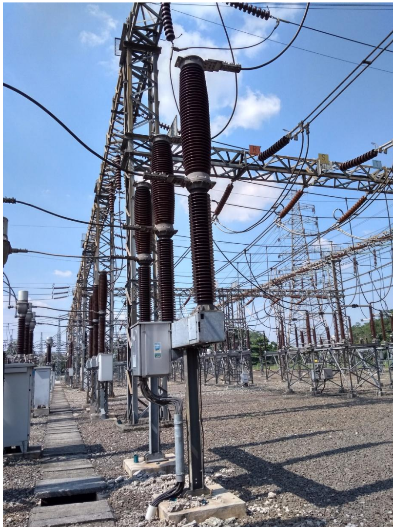
Gambar 4. Transformator Arus pada GI Depok
