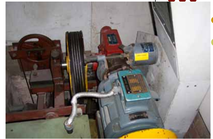
Motor Listrik (Bagian dari Plant yang dikendalikan)
