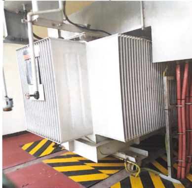
Gambar 2.4 Transformator 20 kV/1200V Gardu Traksi Pasar Minggu.
