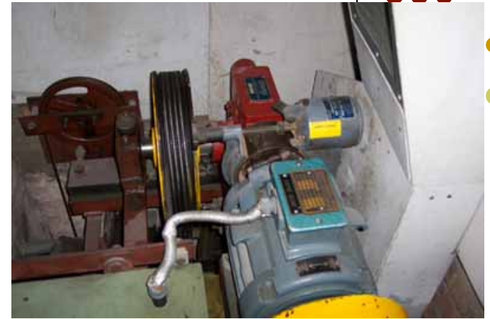
Motor Listrik (Bagian dari Plant yang dikendalikan)
