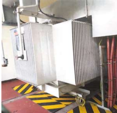
Gambar 2.4 Transformator 20 kV/1200V Gardu Traksi Pasar Minggu.
