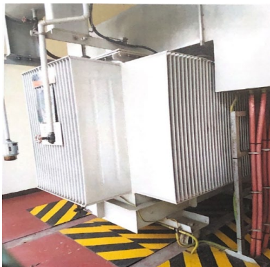
Gambar 2.4 Transformator 20 kV/1200V Gardu Traksi Pasar Minggu.
