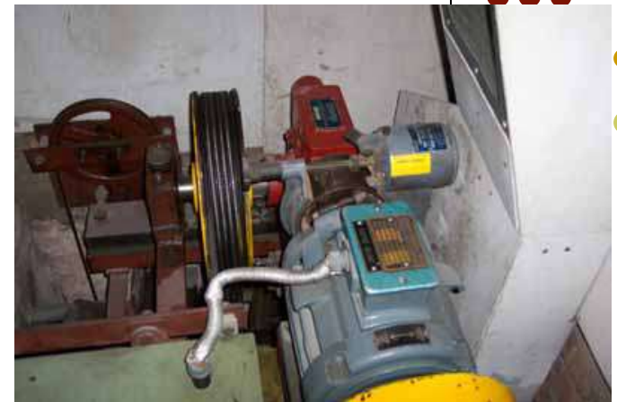
Motor Listrik (Bagian dari Plant yang dikendalikan)
