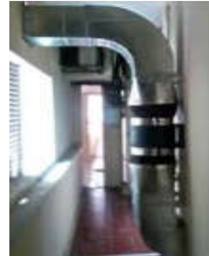
Main Ducting pembuangan asap menuju Exhaust pada atap
