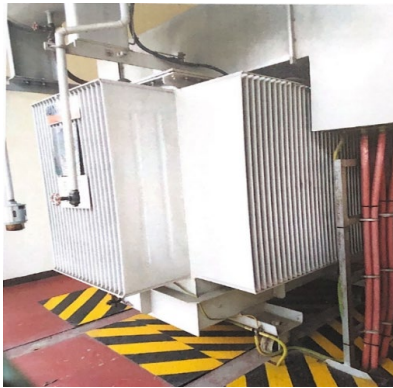
Gambar 2.4 Transformator 20 kV/1200V Gardu Traksi Pasar Minggu.
