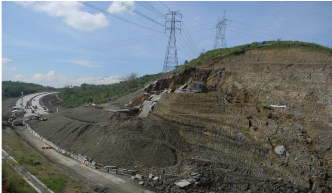
Gambar 4.3 Keruntuhan lereng pada STA 19+250 Jalan Tol Semarang-Bawen, Jawa Tengah (Himawan, 2013)
