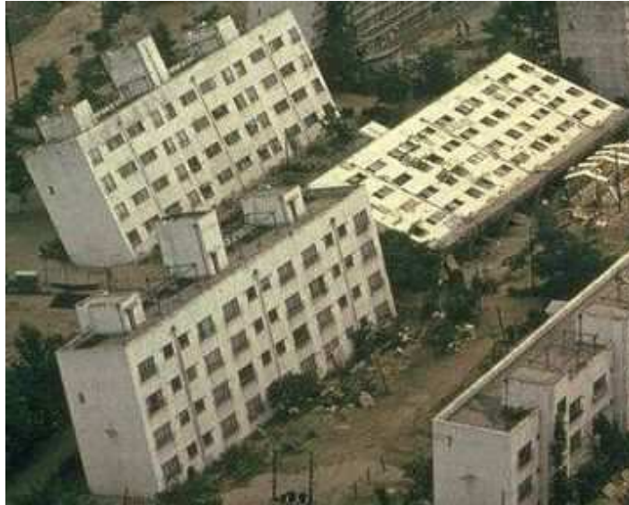
Gambar 2.14. Bangunan yang miring/robok akibat likuifaksi
