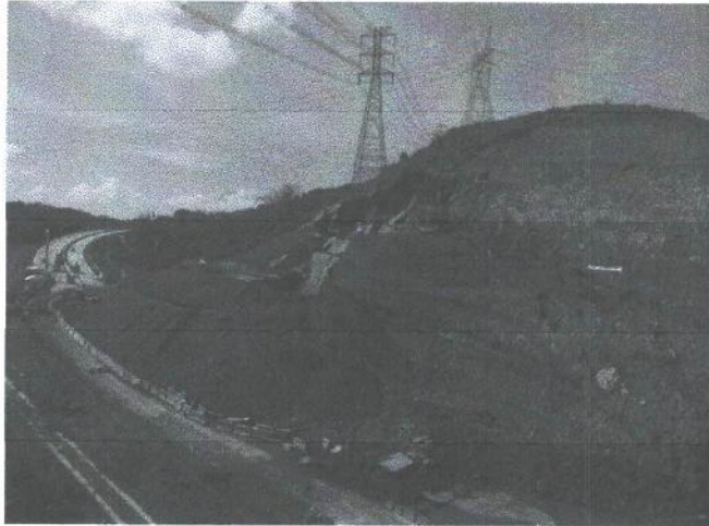
Gambar 1.10 Kelongsoran di rencana Jalan Tol Ungaran Bawen STA 19+250 (Agus Himawan MT, 2011)
