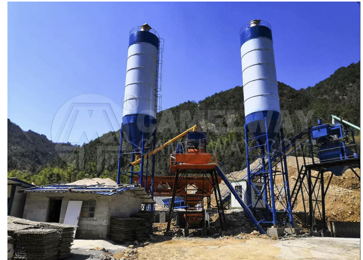
Gambar 11.A.7. Dokumentasi camelway.ic: Mini Batching Plant
