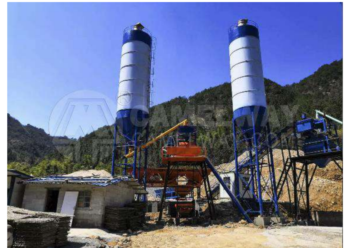
Gambar 11.A.7. Dokumentasi camelway.ic: Mini Batching Plant
