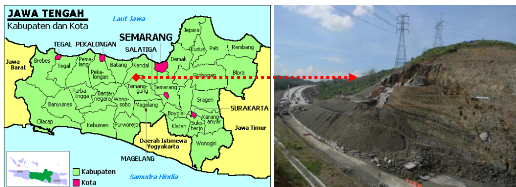
Rajah 1.6 Kegagalan cerun syal lempung di projek jalan Tol Semarang Ungaran Bawen seksyen STA 19+250 (Himawan, 2011)
