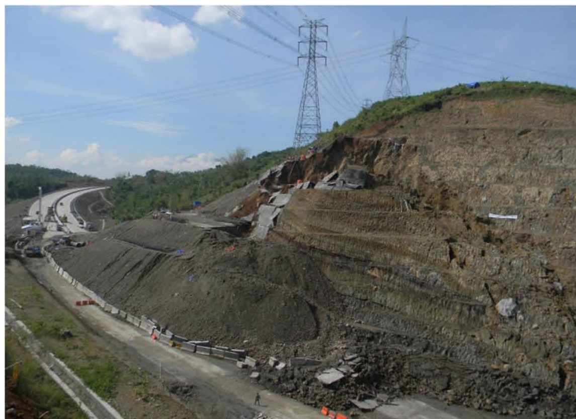
Gambar 2. Kelongsoran pada KM 32+000 Jalan Toll Semarang-Bawen (LAPI ITB PT, 2013)
