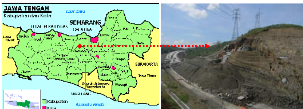
Gambar 1.4 Kegagalan lereng clay shale di proyek jalan Tol Semarang Ungaran Bawen seksyen STA 19+250 (Himawan, 2011)
